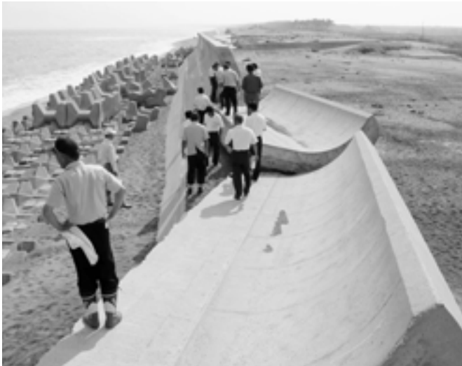
▲台風14号で倒壊した高潮対策用の堤防
