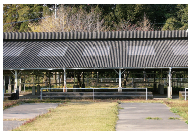
対策が待たれる採光板（岡別府検査場）
