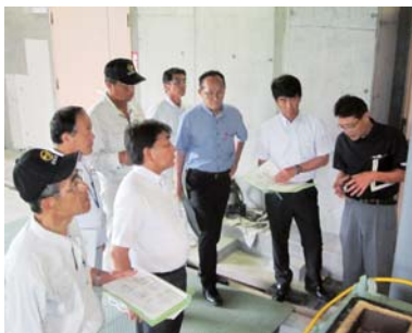
クリーンセンター汚泥処理施設
