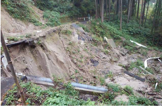
町道崩壊 仮屋谷-松ヶ鼻線
