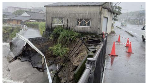
崩落した高尾川の堤防
