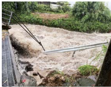
7月豪雨による堤防崩落
