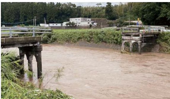
流された飯隈橋
