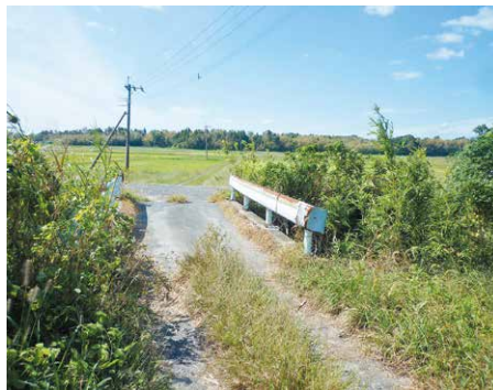
早急な整備が望まれる古川橋一帯
