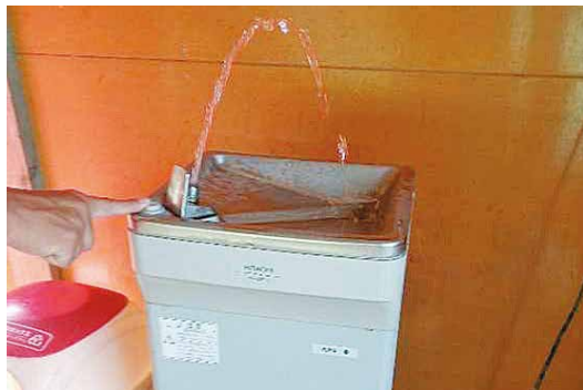
設置が望まれる冷水器
