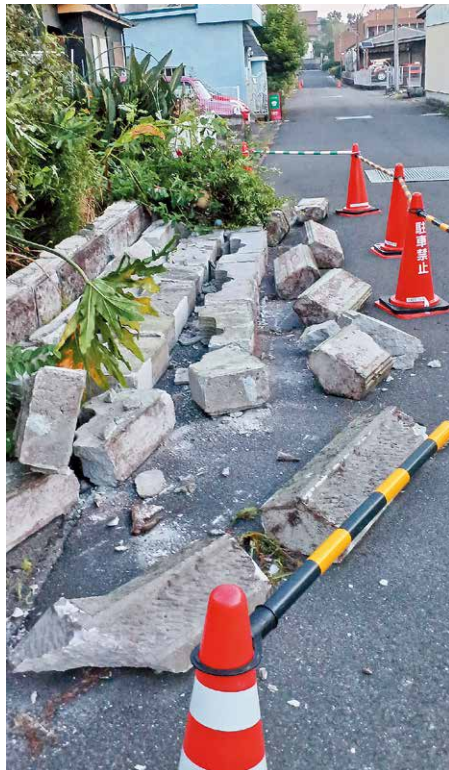
道路へ倒壊したブロック
