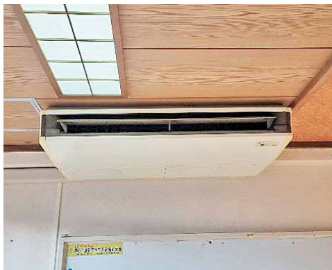
老朽化による基板不良で使用不能状態
