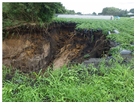
がけ崩れ等による土砂の流出
