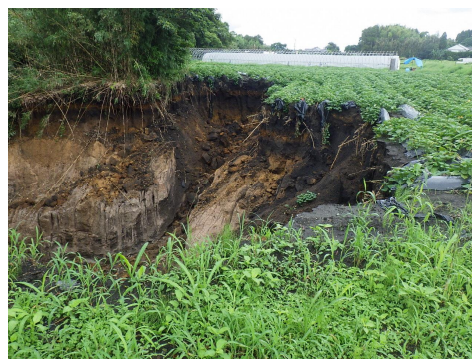
がけ崩れ等による土砂の流出
